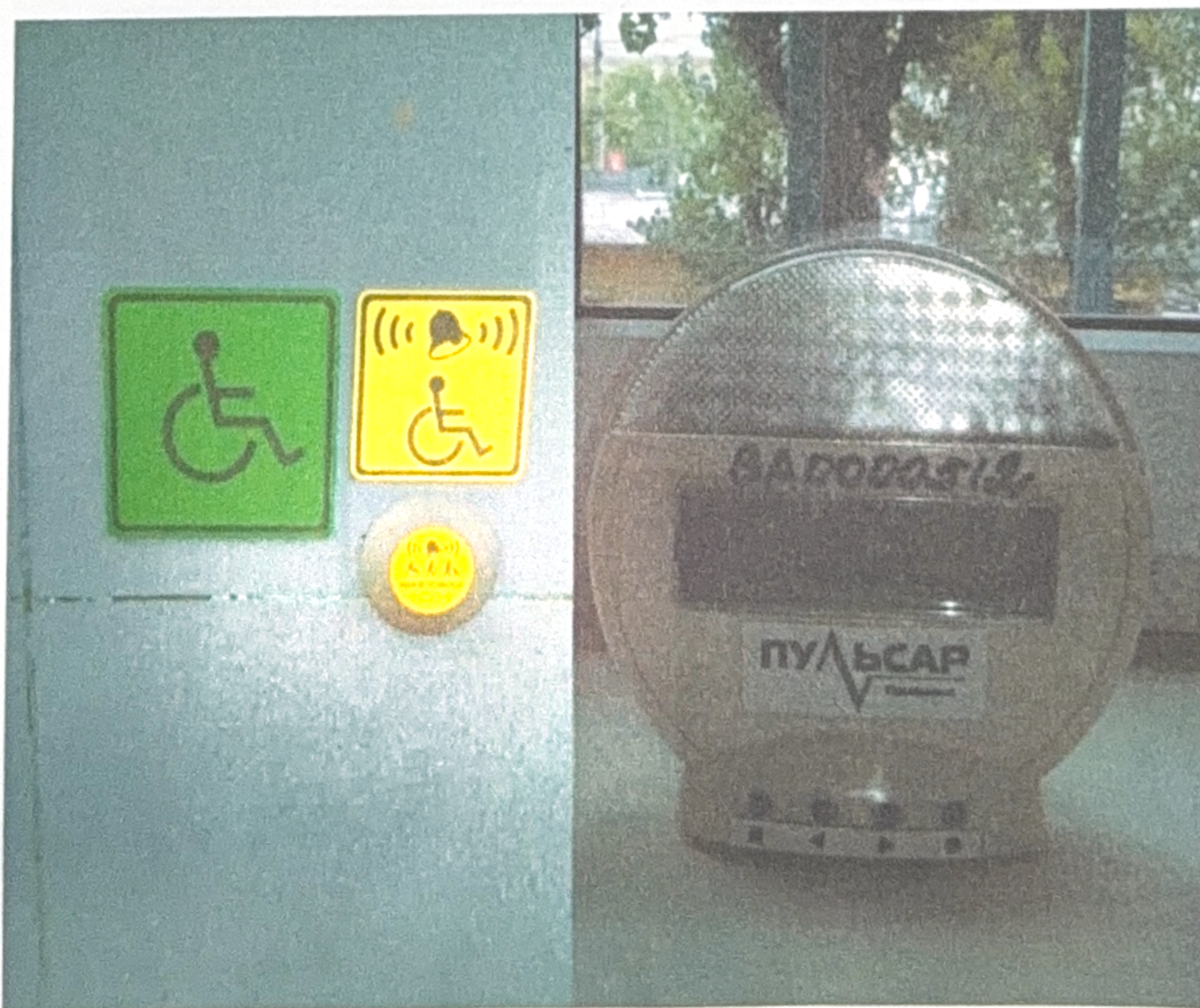
Рис.4. Кнопка вызова персонала, для оказания необходимой помощи (сопровождения).
